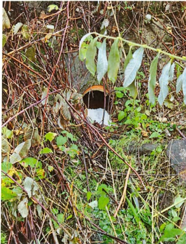
Abbildung 7: Zulauf des RRB 3 von der St 2148 (Stand: September 2025)
