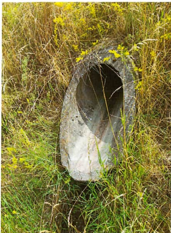
Abbildung 11: Zulauf aus dem Baugebiet zum RRB 2 (Stand: Juli 2025)
