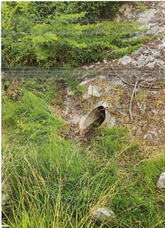
Abbildung 1: Einleitsstelle A 1 in den namenlosen Wiesengraben zum Furthbach mit einem Betonrohr DN 300 (Stand: Juli 2025)
