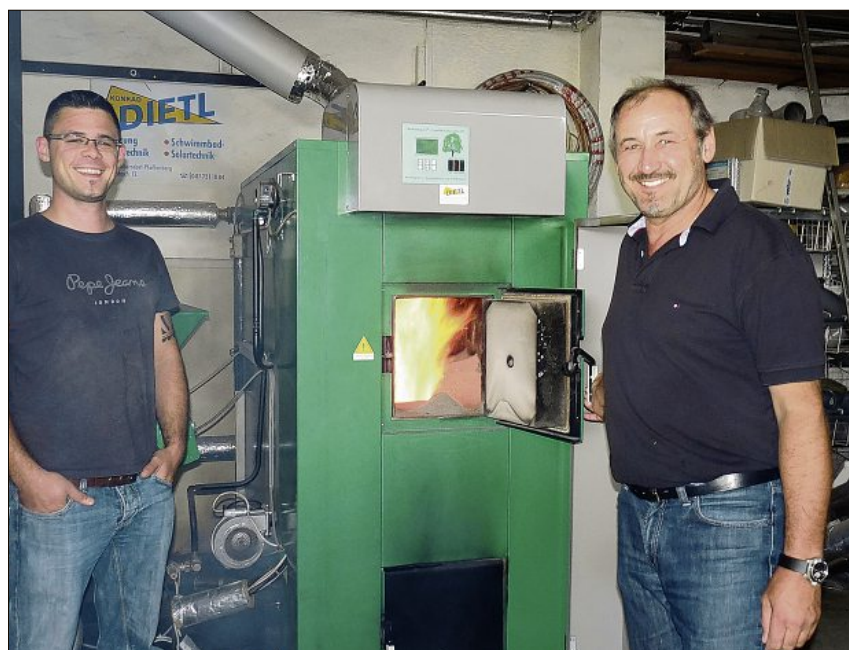
Konrad Dietl (rechts) und sein Sohn Christian, der sich auch als Energy Scout engagiert, am Biokompakt-Heizkessel. Er wird per Schnecke und Feder mit dem Heizmaterial bestückt.
