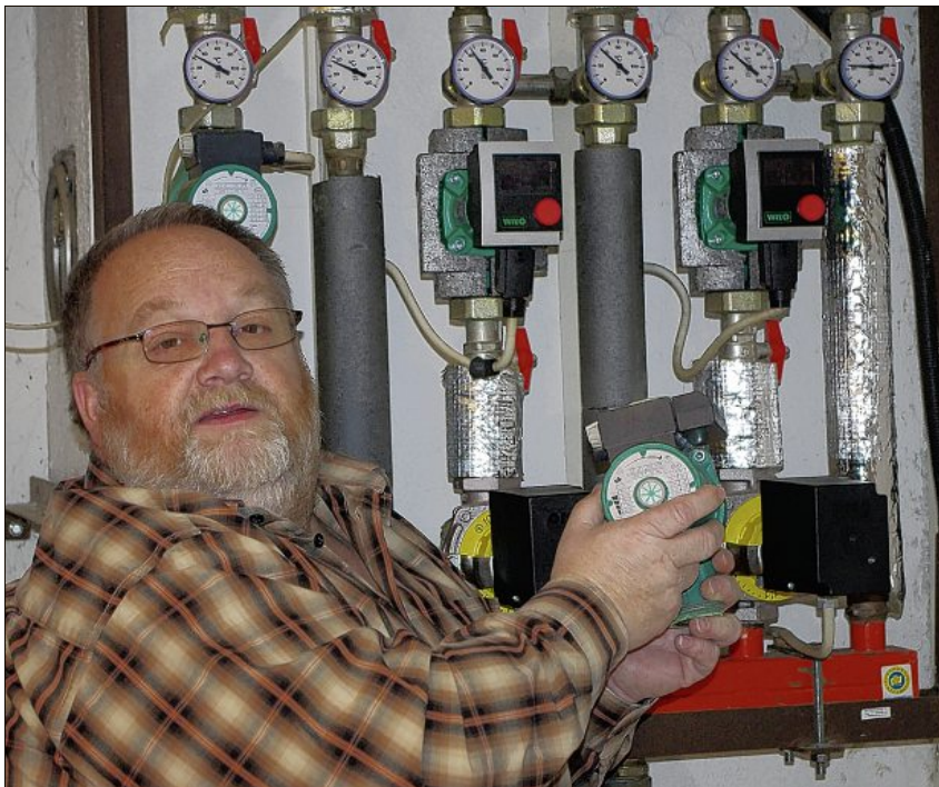
„Deutlich weniger Stromverbrauch – bis zu 80 Prozent“: Dies kann Peter Seubert nach dem Einbau einer Hocheffizienzpumpe in seinem Haus bestätigen.
